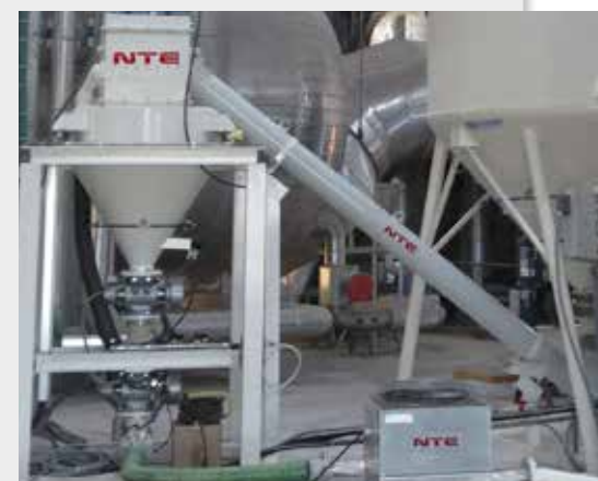
Skid per abbattimento SO 2 e HCl con Eco Lance®
